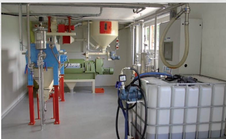
Die Kernelemente der Ölmühle: Seiher-schneckenpresse und elektr. Lufterhitzer (hinten), Kammerfilterpresse (links), Feinfiltration und Steuerschrank (rechte Wand).
